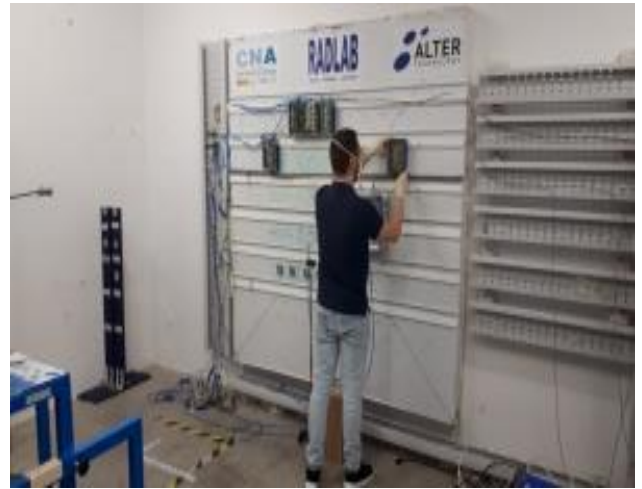
Instalaciones de la Unidad del Irradiador de Cobalto-60
